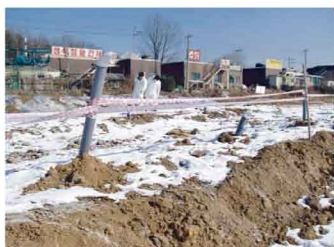
埋設した家畜が腐敗して地面が陥没
